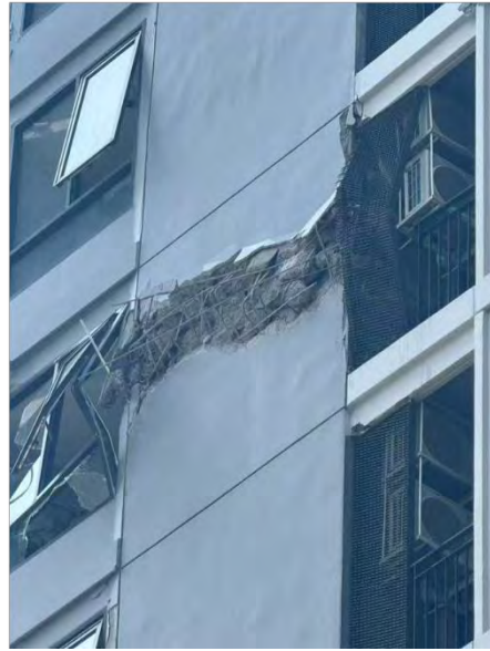
(d) Wall damage on the 9 th floor
