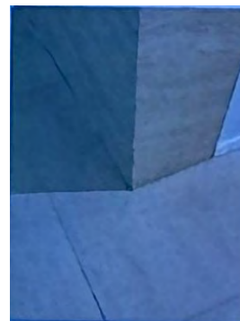
(d) Cracks on ceramic tiles (Floor 14)
