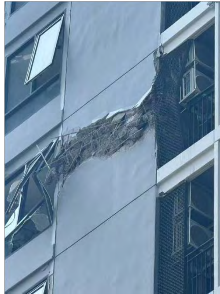
(d) Wall damage on 9 th floor
