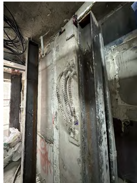
(d) Buckled bars left exposed, 9 th floor
