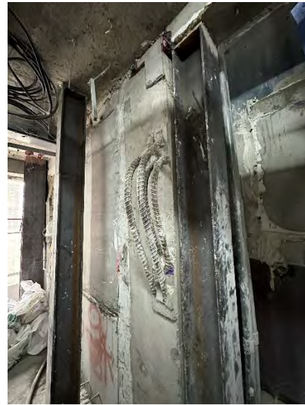
(d) Buckled bars left exposed, 9 th floor
