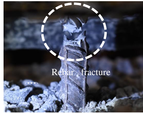
f) Rebar fracturing
